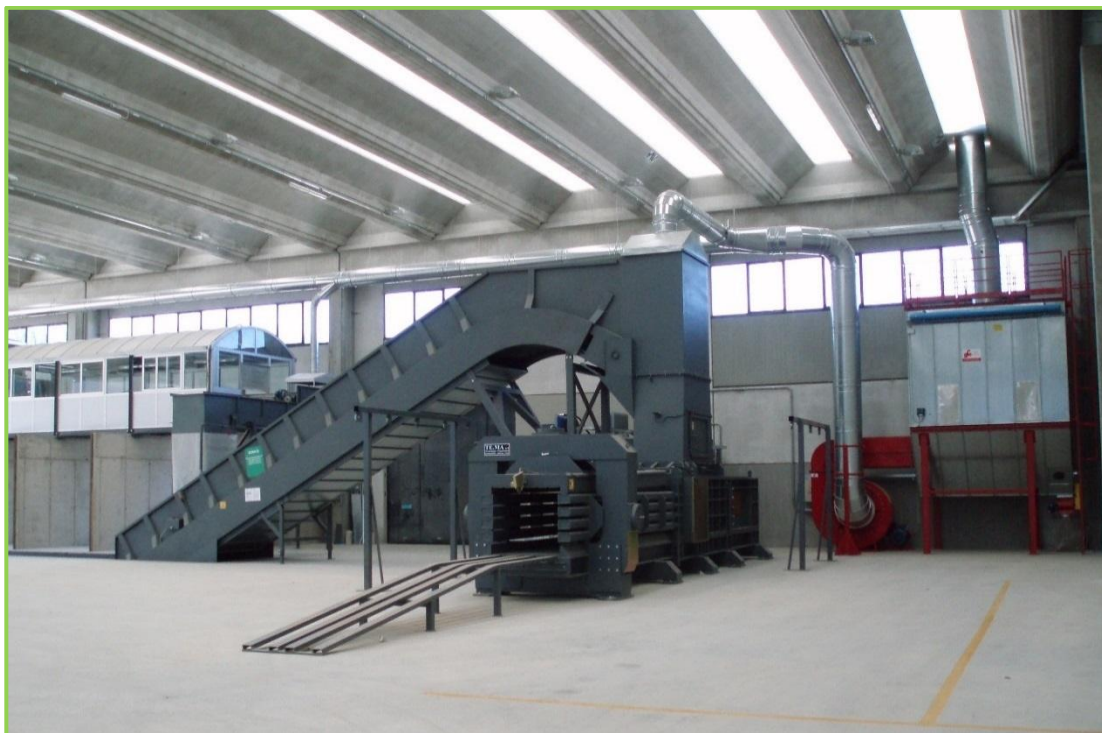
Figura 5: Impianto di selezione e pressatura
